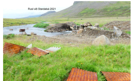
Mynd 13. Ræsið yfir Stardalsá hefur verið eyðilagt.
